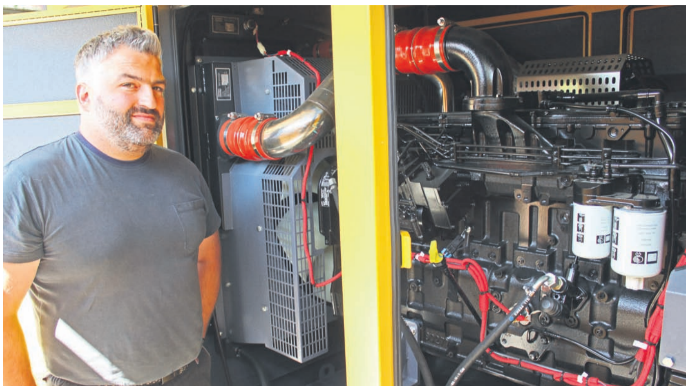
Der technische Leiter des Marienstifts, Matthias Ebert, zeigt das Innenleben des Notstromaggregats.
